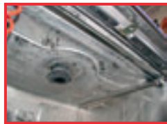
Chambre de rinçage d'une machine de nettoyage et de désinfection
